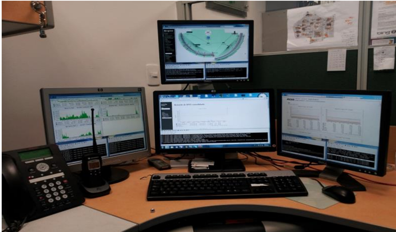
Fotografía 2. Centro de Operaciones de Red – Universidad Industrial de Santander
