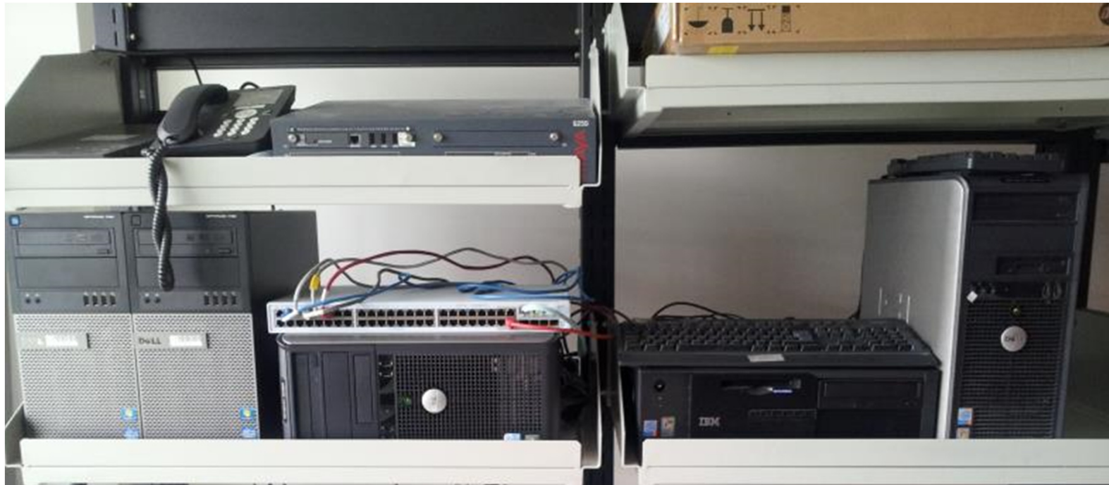
Fotografía 1. Servidores del Centro de Operaciones de Red – Universidad Industrial de Santander
